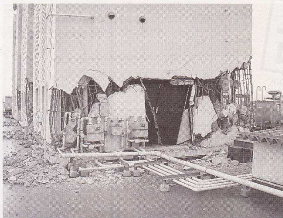
東北大学の工学研究科の建物の屋上部分が壊れていた＝東北大提供
