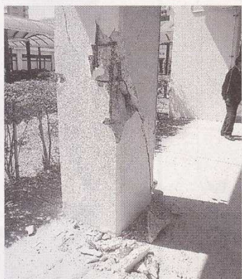
工学部系の建物の地上部の柱がひび割れ、中の鉄筋が曲がっている＝山上写す
