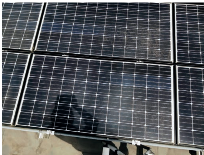
本館太陽光発電（10kW）
