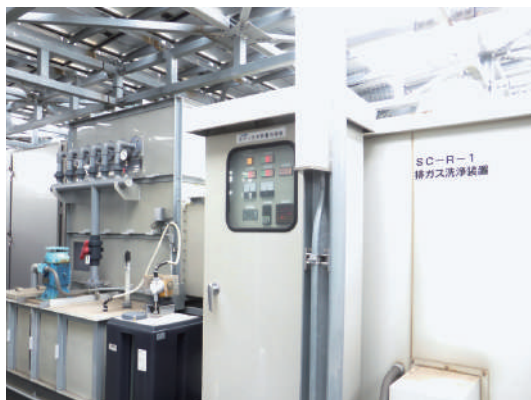
大岡山 北3号館屋上の排ガス処理装置
