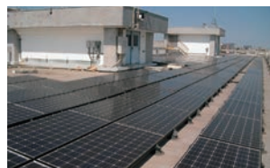
緑が丘1号館 (72kW)
