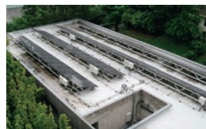
緑が丘4号館 (57kW)
