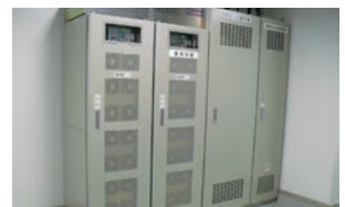
リチウムイオン電池 (96kWh) 大岡山北3号館
