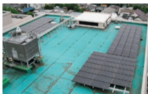
石川台1号館 (61kW)
