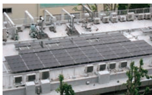
大岡山北1号館 (38kW)
