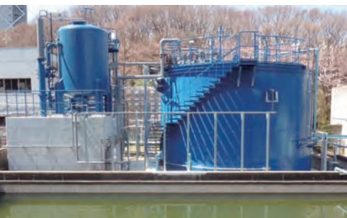
すずかけ台地区実験廃水処理施設
