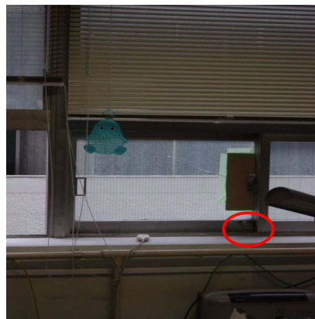
南3号館 補助錠の設置で侵入を未然に防いだ箇所
