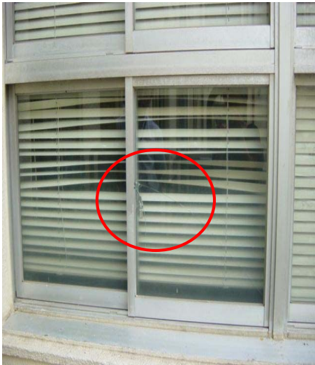
本館地下1階の侵入箇所
